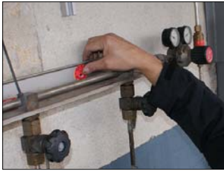
Inspektionsdekaler på centralgassystemet samt bakslagspärrar uppdateras.
